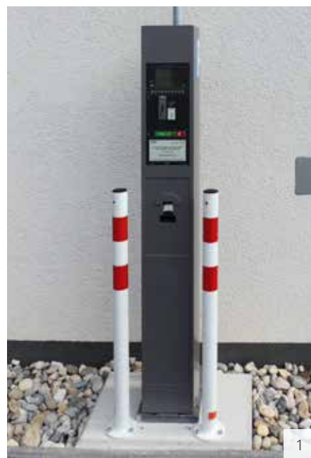
Image 1: des poteaux de barrage protègent l'horodateur des dommages causés par les véhicules
