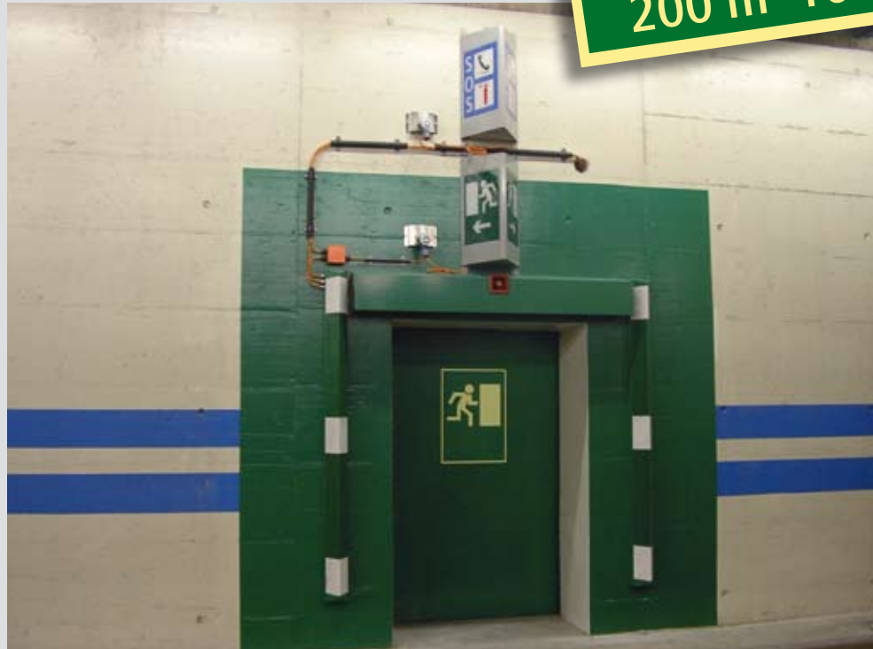
Milchbucktunnel: Fluchtwegtüre optimal durch permanent ausgeleuchtete Signale ausgestattet
