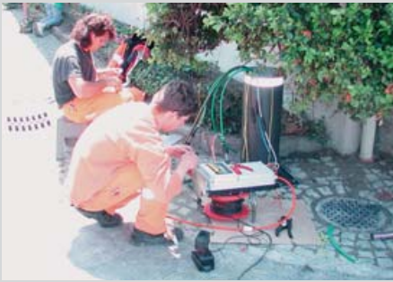
Installation der elektronischen Steuerung im verdeckten Poller
