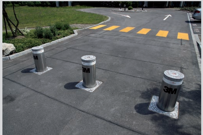
Induktionsschleifen vor und nach der Pollerreihe
