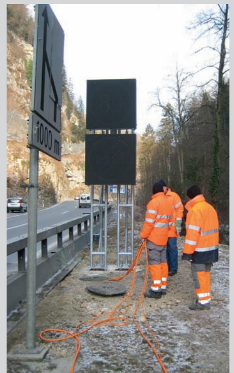
Inbetriebnahme der Anlage
