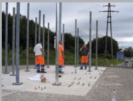
Verschraubung der Rohrmasten
