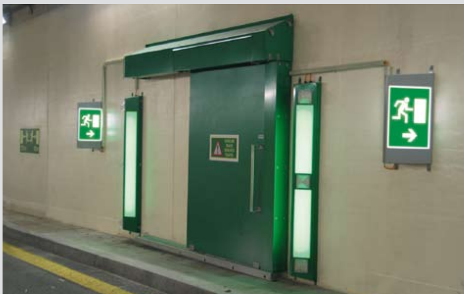
Signalisation mit ausgeleuchteten Fluchtwegsignalen und Notausgang-Umrandungen
